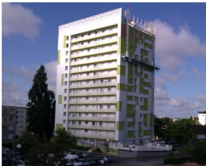
Rénovation - Résidence Marie Stuart Tour T - Maître d'ouvrage : Les Résidences de l'Orléanais
