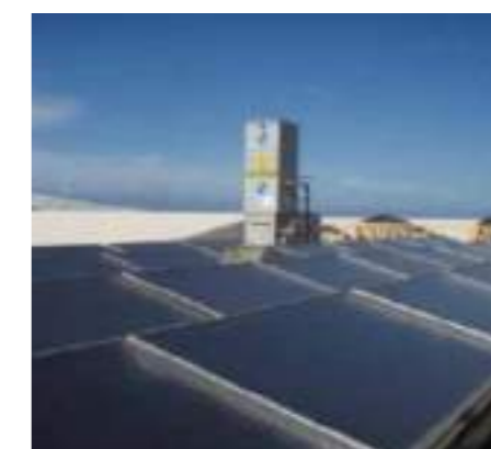
Figure 22 – Rafraîchissement Solaire RAF SOL / ANR ORASOL - Climatisation Solaire
